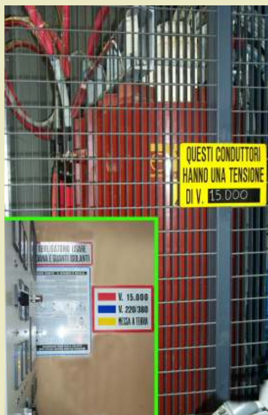
Cabina di trasformazione MT/BT
