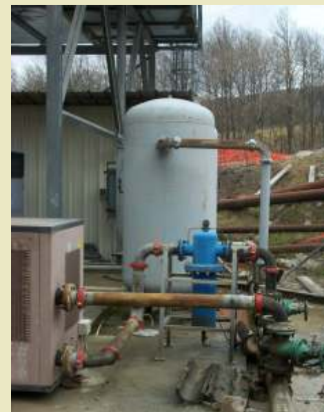
Serbatoio aria compressa a servizio dell'impianto di distribuzione in galleria
