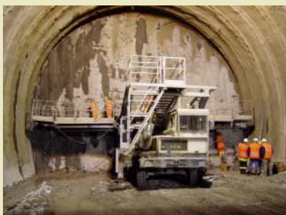
Foto 3: Autotelaio con piattaforma di lavoro
